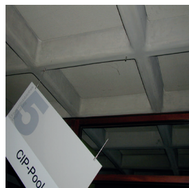
BEISPIEL: WEGWEISERBEFESTIGUNG DEFECT
